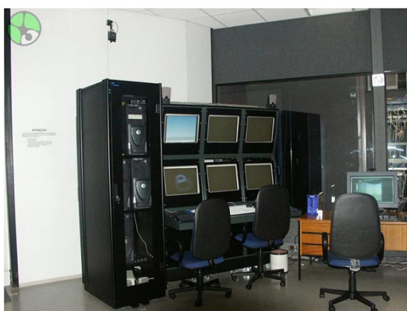
Figura 12 - Sala de Controle da CAVE (LSI-USP, 2007)
